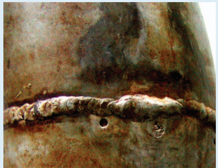
Undichtigkeit in Wasserleitung aus 316L
