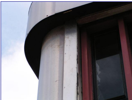
Ablagerung auf Edelstahl-Fassadenverkleidung
